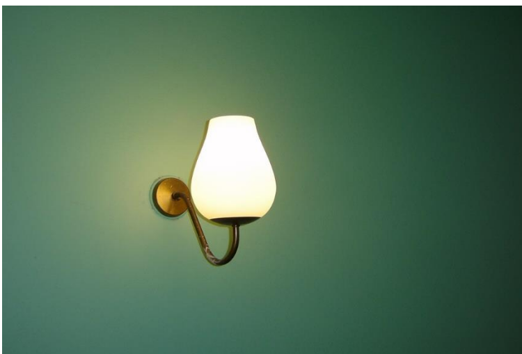
Opprinnelig lampe i trapperom
