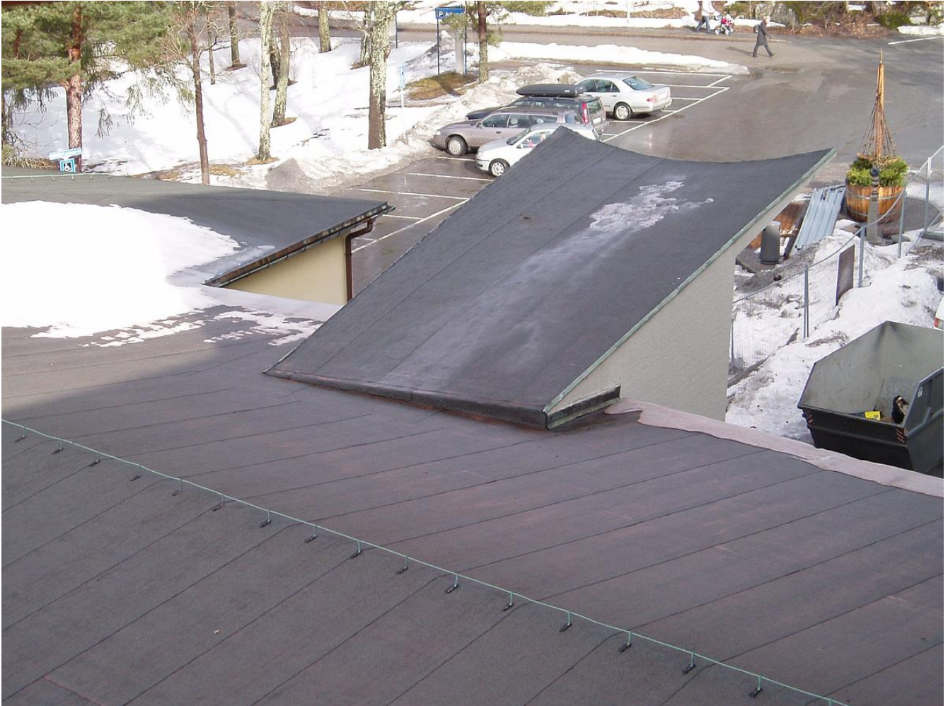
Taket over vestfløyen med takpapp banetekking og takfotbeslag, takrenner og nedløp i kobber. Foto: Ingrid Djupedal, Riksantikvaren 2007
