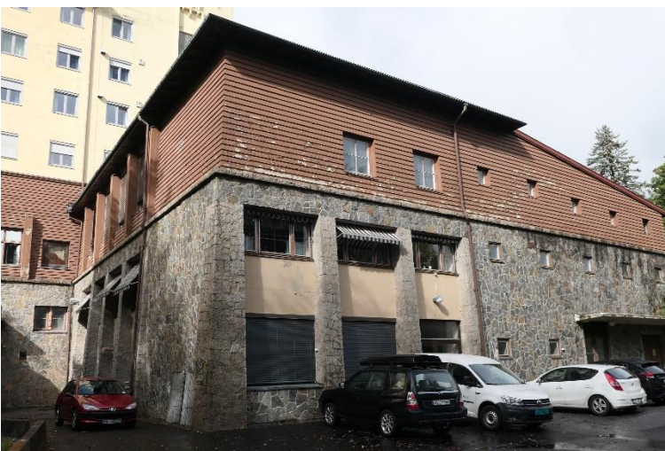
Østfløyens sydvegg og østvegg, begge med «kontreforter» i bruddstensforblendet betong og med «supanel» av malt betong.
