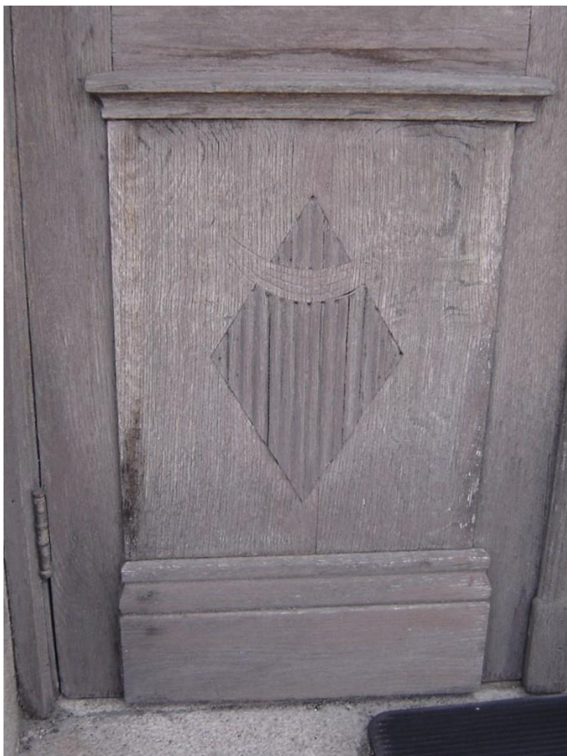
Detalj av gateportal, ant. fotografert i 2006: Dørbladfelt med karakter av drapert tekstil har siden falt ut. (fotograf ukjent, bilde fra SØHF)
