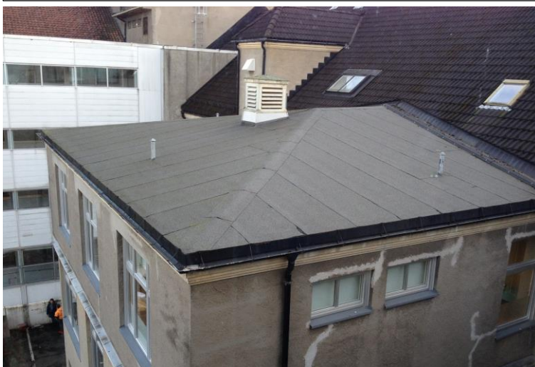
Påbygget til operasjonsfløyen, med papptekking. I bakgrunnen t.v. forbindelsesgangen mot det tidligere sentralsykehuset.
