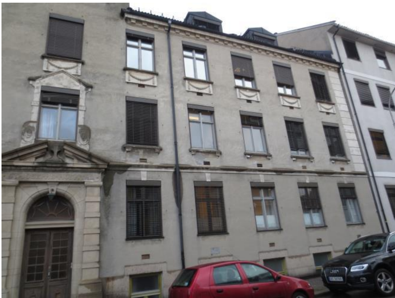
Over: Første byggetrinns gatefasade, med takrenne. Den våte flekken langs takrennen viser at det er høyere vannpåkjenning der enn i mesteparten av fasaden ellers. Dette kan skyldes takrennen, eller egenskaper ved fasaden for øvrig, slik som at det er et hull i trekningen akkurat der. Foto fra SØHF
