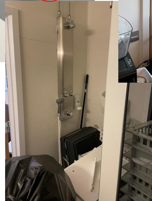
Blindgjengere! Avsteng varmtvann og dusjer som ikke er i bruk
